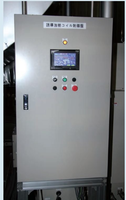
▲ 誘導加熱装置の制御盤
